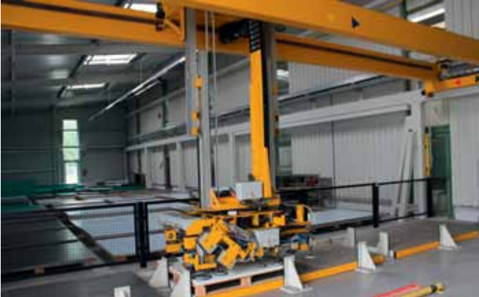
② Das Portal mit dem Saugerrahmen bewegt sich zur neuen Ware und nimmt sie auf...
